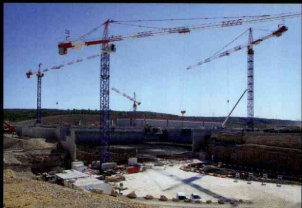
Le chantier du réacteur expérimental de fusion, déployé sur 42 hectares, mobilise 1000 personnes aujourd'hui (5 000 en 2015).
